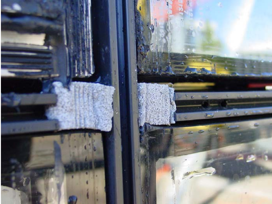
Bild 13 Isolatoren mit Fugendichtband am Kreuzungspunkt
