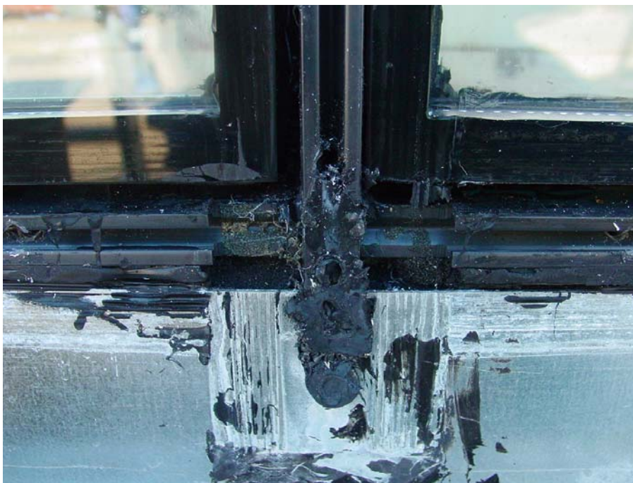
Bild 18 Isolatoren am Sockelpunkt
