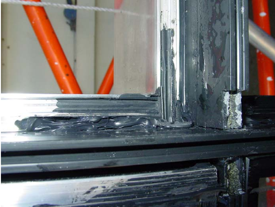
Bild 15 Abdichtung der inneren Verglasungsdichtung im Eckbereich
